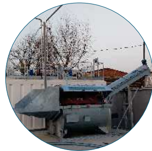
Metallic tank - recycled water Réservoir métallique - l'eau recyclé
